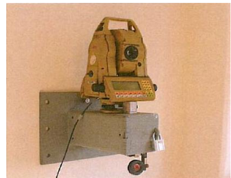
3-8. ábra TCA2003 az alagút szakaszban
